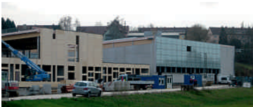
Die Arbeiten für die Schule liegen im Zeitplan. Die Kosten sind ebenfalls im vorgesehenen Rahmen.
